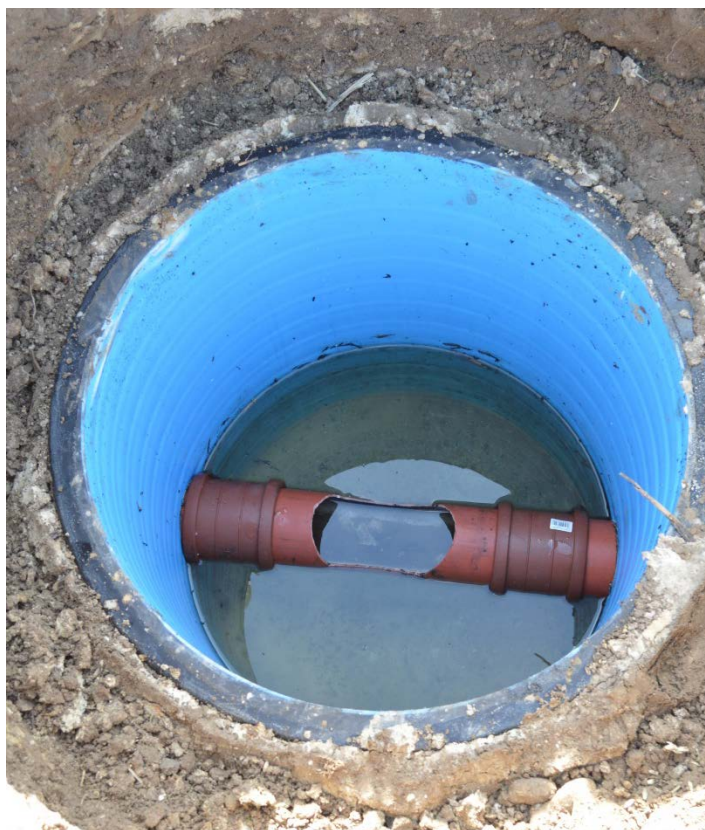
Figur 5 På billedet ses en observationsbrønd på et sidedræn, hvor der har været foretaget styret dræning, der er en del sediment(og vand) i røret, og det skyldes formentlig, at der er en lunke på drænrøret ved observationsbrønden, idet afvandingsdybden på drænet ikke var hævet i forhold til drændybden på dette tidspunkt, og mængden af drænvand desuden var moderat.
